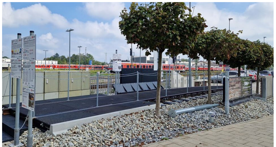
Abb. 4: Mini-Lärmschutzwand, Geländerausfuchung, schwellenloser Bahnübergang und Schraubfundamente
